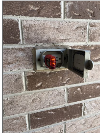
Exterior GFCI outlet.
