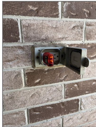
Exterior GFCI outlet.
